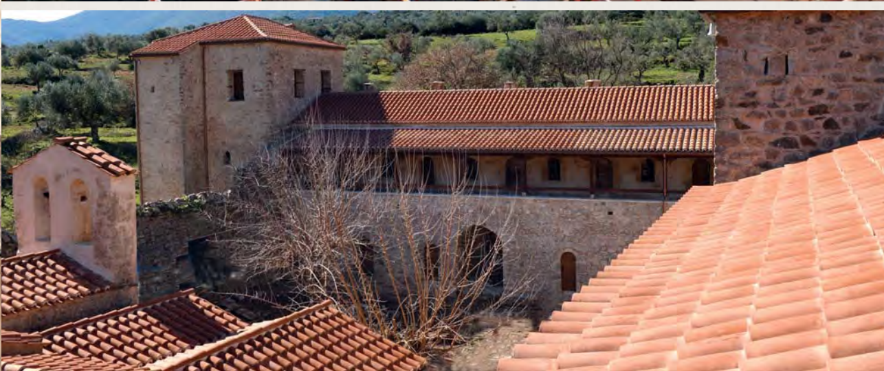
Απόψεις της δυτικής πτέρυγας και του νοτιοδυτικού πύργου κατά τη διάρκεια και μετά την ολοκλήρωση των εργασιών Views of the west wing and the southwest tower during and after the restoration
