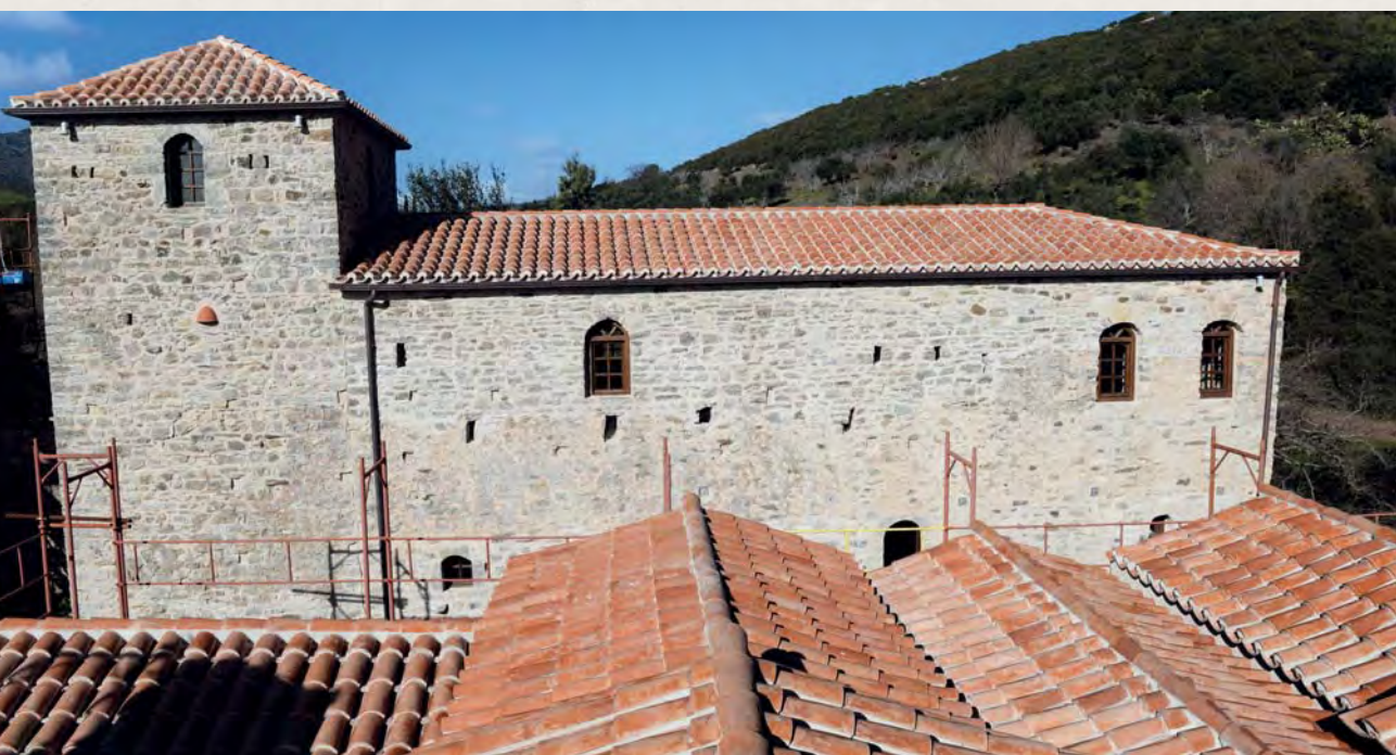
Τράπεζα και βόρειος πύργος. Απόψεις από τα νότια κατά τη διάρκεια και μετά την ολοκλήρωση των εργασιών The refectory and the north tower during and after the restoration. Views from the south
